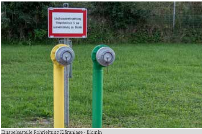
Einspeisestelle Rohrleitung Kläranlage - Biomín
